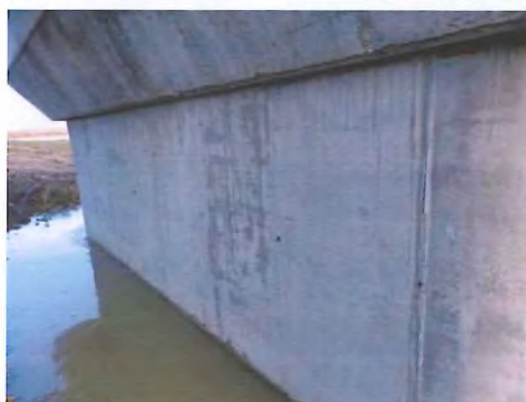
6.7.12-3 Segregări și fisuri verticale
