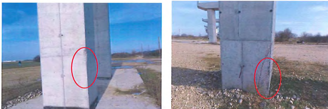
Fig. 6.7.5-3 Degradări pile (muchii lovite)
