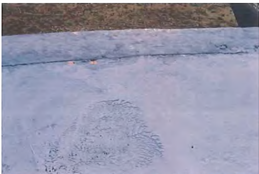
Fig. 6.7.6-6 Finisare necorespunzătoare a suprafeței plăcii de suprabetonare
