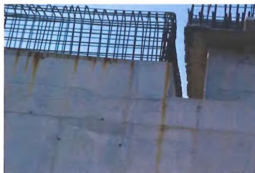
Fig. 6.7.3-6 Oxid de fier scurs pe fața elementelor turnate, din cauza abandonării lucrării și neconservarea acesteia
