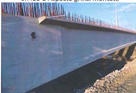
6.7.11-3 Corodări ale armăturilor lăsate neprotejate
