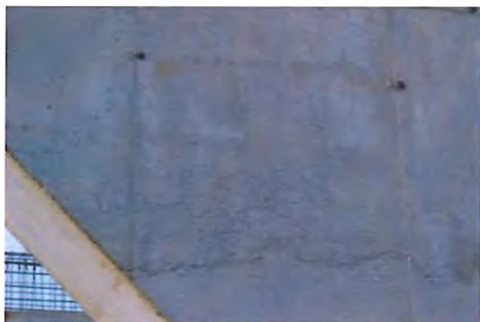
Fig. 6.7.3-5 Segregări ale betoanelor și rosturi de turnare tratate necorespunzător
