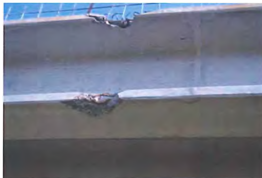
Fig. 6.7.6-2 Degradări pile (muchii lovite)
