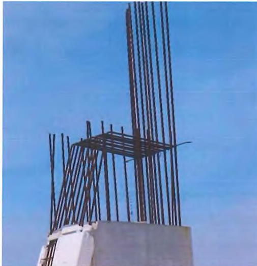
Fig. 6.7.1-2 Aspecte elevații culee – Zone cu segregări
