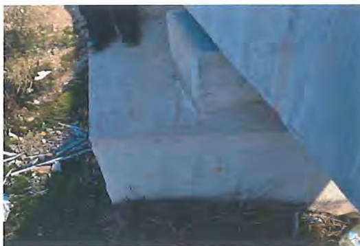
6.7.11-5 Fisuri în bancheta culeei C2
